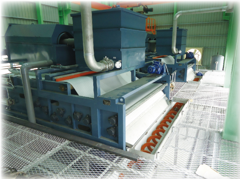
輸送汙泥設備
